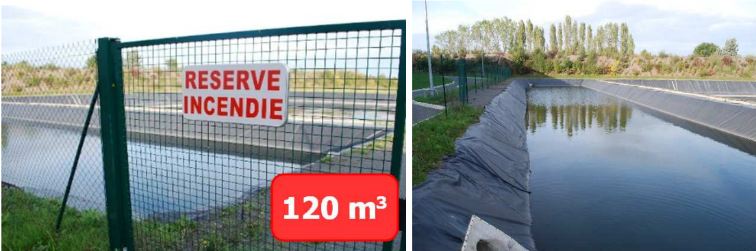
Réservoirs à l'air libre sur sites industriels
